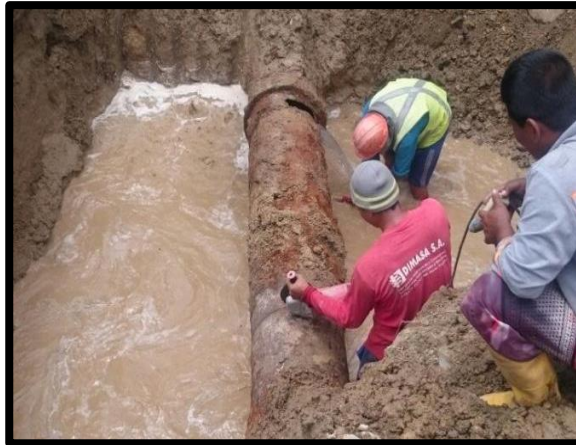
Imagen 2. Daños en Acueducto Santa Martha
