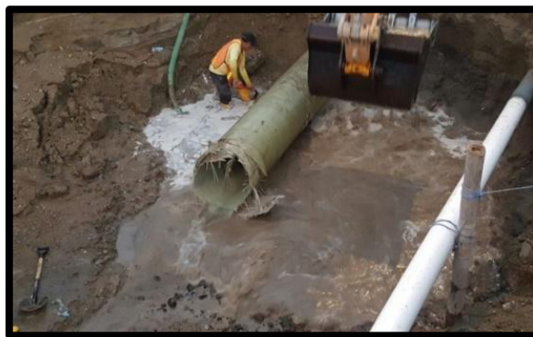
Imagen 3. Daños en acueducto Colorado - Santa Martha
