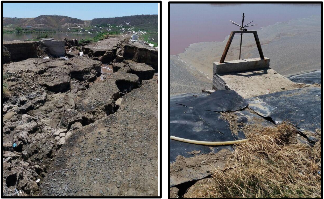
Imagen 5. Daños en el sistema de tratamiento de aguas residuales
