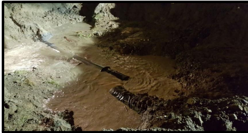
Imagen 1. Daños en captación PTAP “Ceibal”
