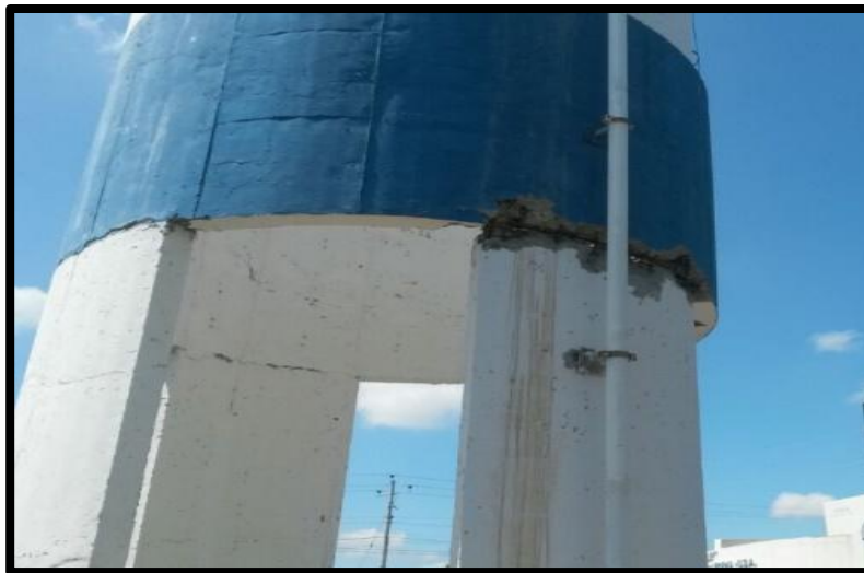
Imagen 4. Daños en sistemas de bombeo y tanques elevados
