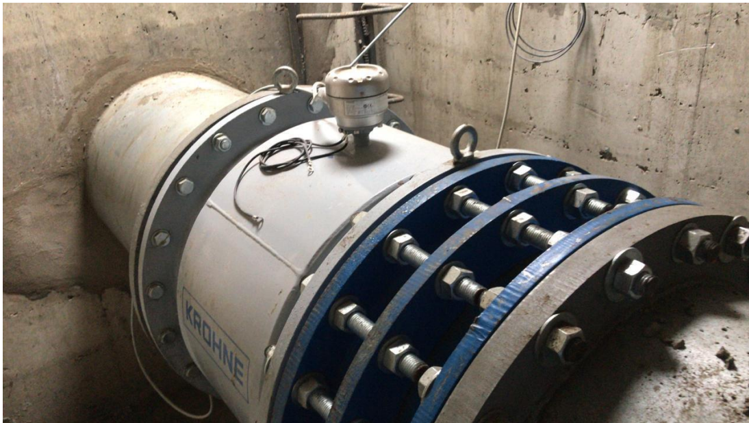
Imagen 17. Caudalímetro electromagnético del punto del punto de Conducción Colorado – Santa Martha (M-012).
