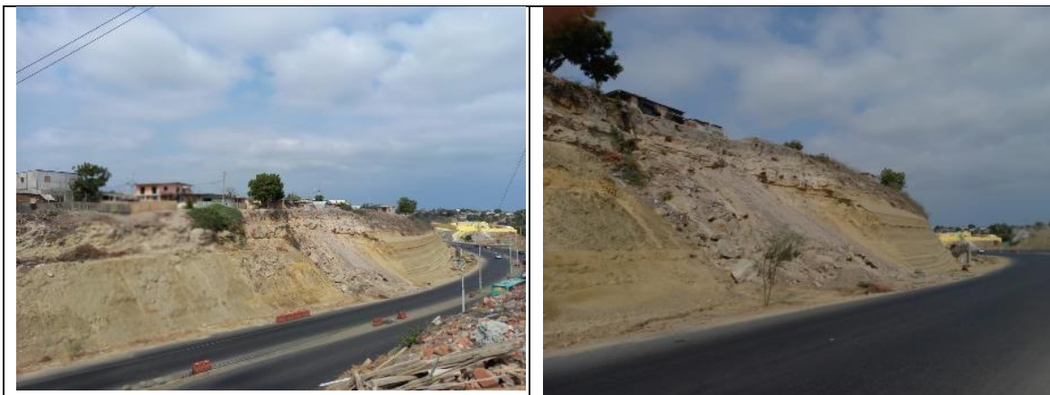
Fotografía 3 Sector crítico por inestabilidad en Tramo 13 Calle 293
